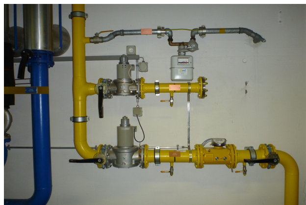
1 Condotta di gas naturale posata a vista
