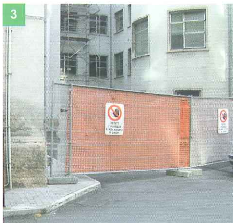
3 DELIMITA IL POSTO DI CARICO A TERRA DELL'ARGANO
