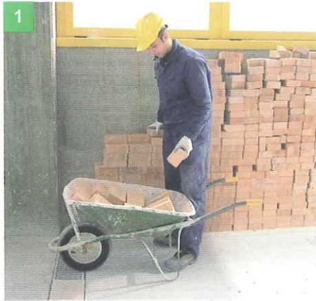
1 CARICA IN MODO APPROPRIATO LA CARRIOLA
