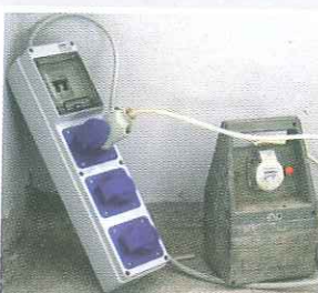
QUADRO ELETTRICO PORTATILE
