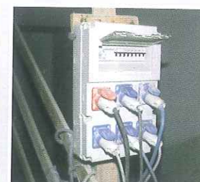
QUADRO ELETTRICO SECONDARIO
