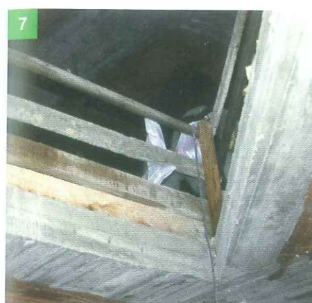
RECINGI CON UN PARAPETTO REGOLAMENTARE I FORI GRANDI
