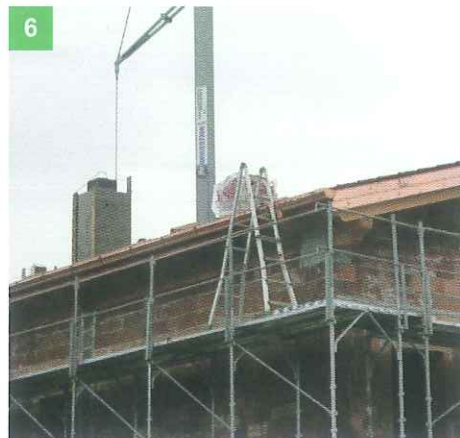
NON SALIRE SULLE COPERTURE CON MEZZI DI FORTUNA
