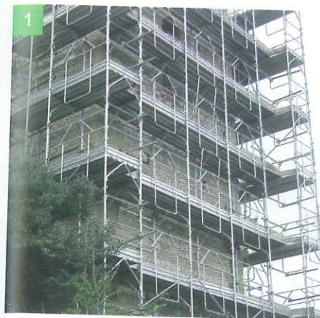
1 OLTRE I DUE METRI DI ALTEZZA DEVI LAVORARE SU UN PONTEGGIO MUNITO DI PARAPETTO REGOLAMENTARE
