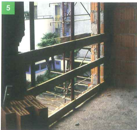
CHIUDI I FORI APERTI SUL VUOTO, CON PARAPETTO DA UN METRO E TAVOLA FERMAPIEDE DA CM 20
