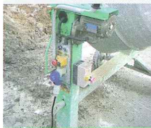
Accertati se funzionano i sistemi di sicurezza dell'impianto elettrico
