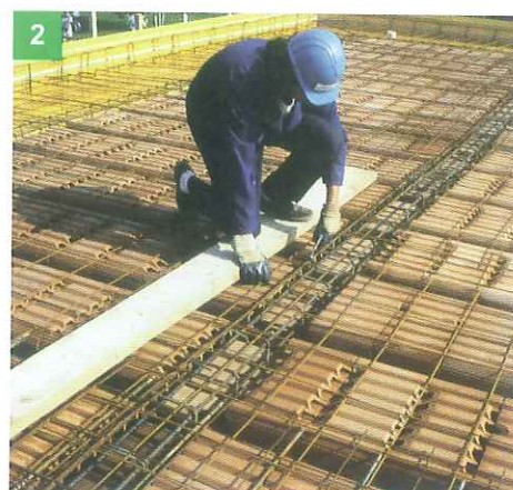
2 PRIMA DI CAMMINARE SULLE PIGNATTE DI UN SOLAIO DISPONI DEI TAVOLONI
