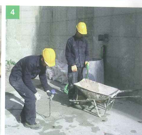
4 NON FAR PASSARE I CAVI ELETTRICI IN LUOGHI BAGNATI
