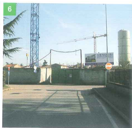
6 PONI I CAVI AD UN'ALTEZZA DI METRI: - 2 DOVE PASSANO LE PERSONE - 5 DOVE PASSANO MEZZI MECCANICI
