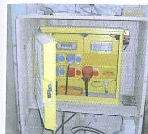
QUADRO ELETTRICO DI CANTIERE
