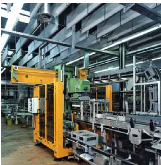
Figura 81: soffitto fonoassorbente in una fabbrica di imbottigliamento. Qui si impiegano dei pannelli in lana minerale (cosiddetti «baffles»).
