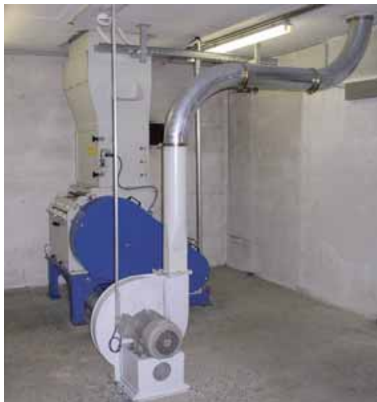
Figura 77: trituttore di materie plastiche in un locale separato.
