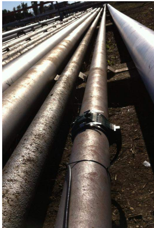
Figura 5 Allestimento strumentale del sistema di monitoraggio ad Onde Guidate connesso in maniera permanente ad una tubazione di un impianto petrolchimico in Italia
