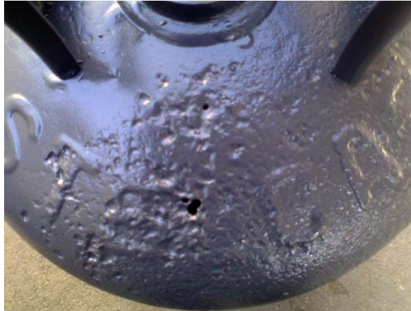
Foto 3. Corrosione profonda con foratura
