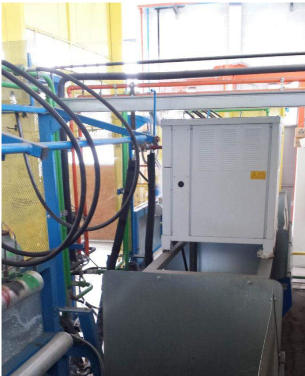
Immagine 2 – Generatore di vapore
