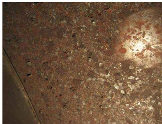
Figura 6 – Zona dei fondi con evidenti pits di corrosione
