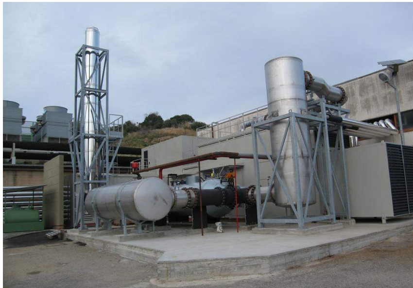
Fig. 4 – Vista dell'impianto di trigenerazione
