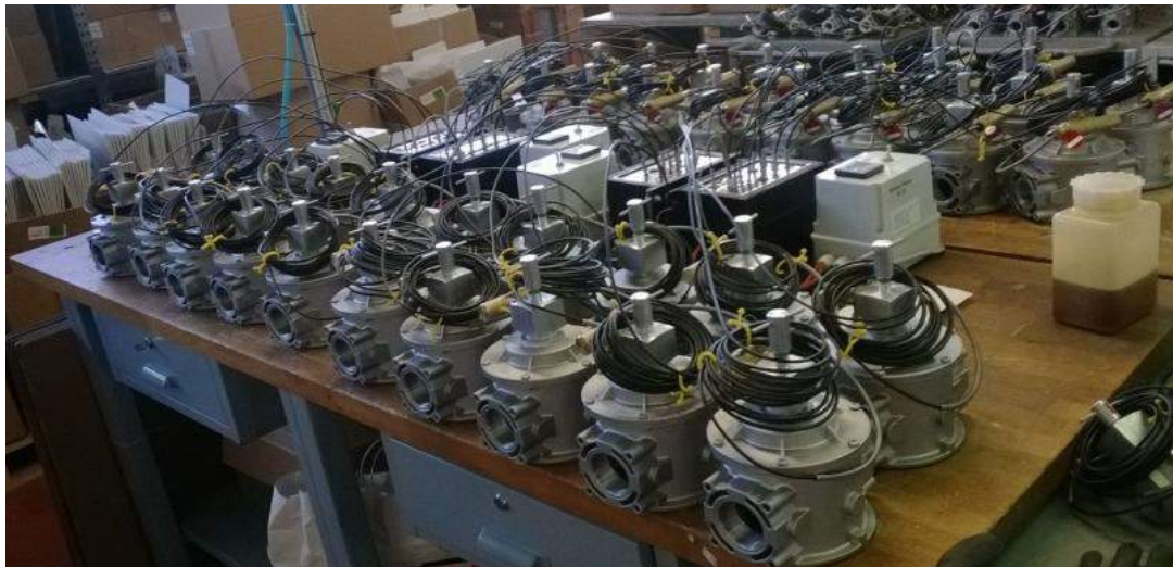
Figura 7 – Banco di verifica della taratura della MADAS
