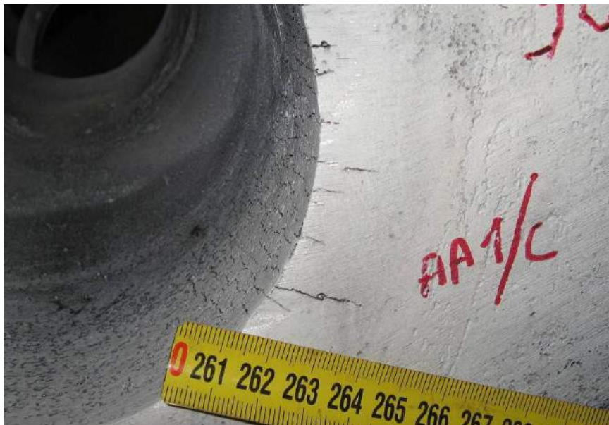
Figura 2 – Esempio dei danneggiamenti riscontrati su alcune forature dei corpi cilindrici
