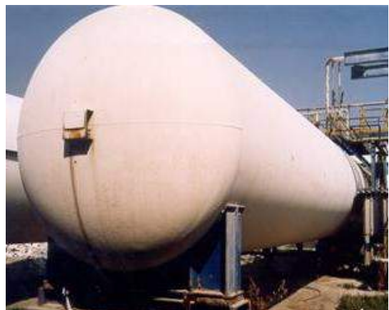
Fig. 3. Serbatoio cilindrico orizzontale
