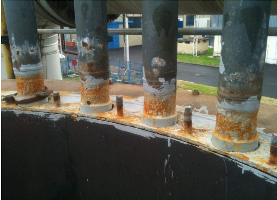
Foto1: esempio di corrosione uniforme e continua
