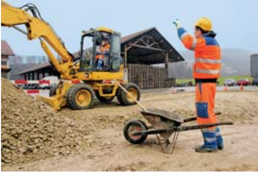
1 Mantenere il contatto visivo con il macchinista
