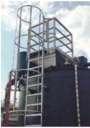
1 Accesso di tipo fisso con scala a pioli
